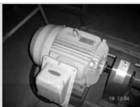
Motor eléctrico trifásico de 18,5 kW
